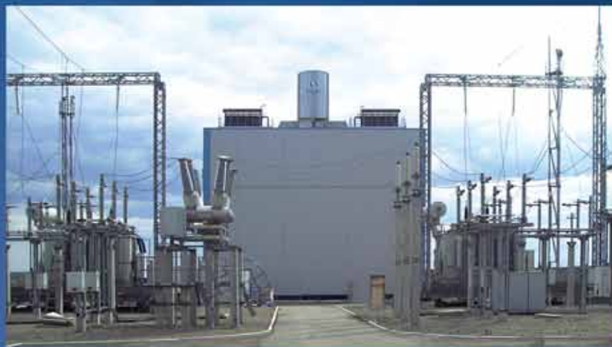
Подстанция ГТ ТЭЦ (Республика Калмыкия)
