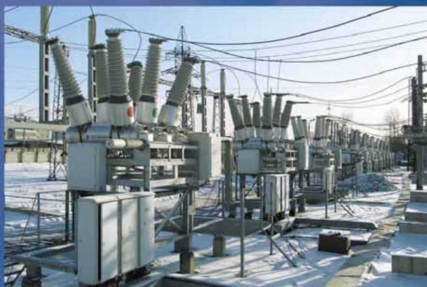
Подстанция «Центральная», г. Благовещенск (Амурская область)
