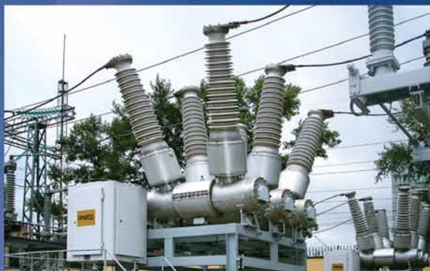
Подстанция «Мальшевская», г. Екатеринбург
